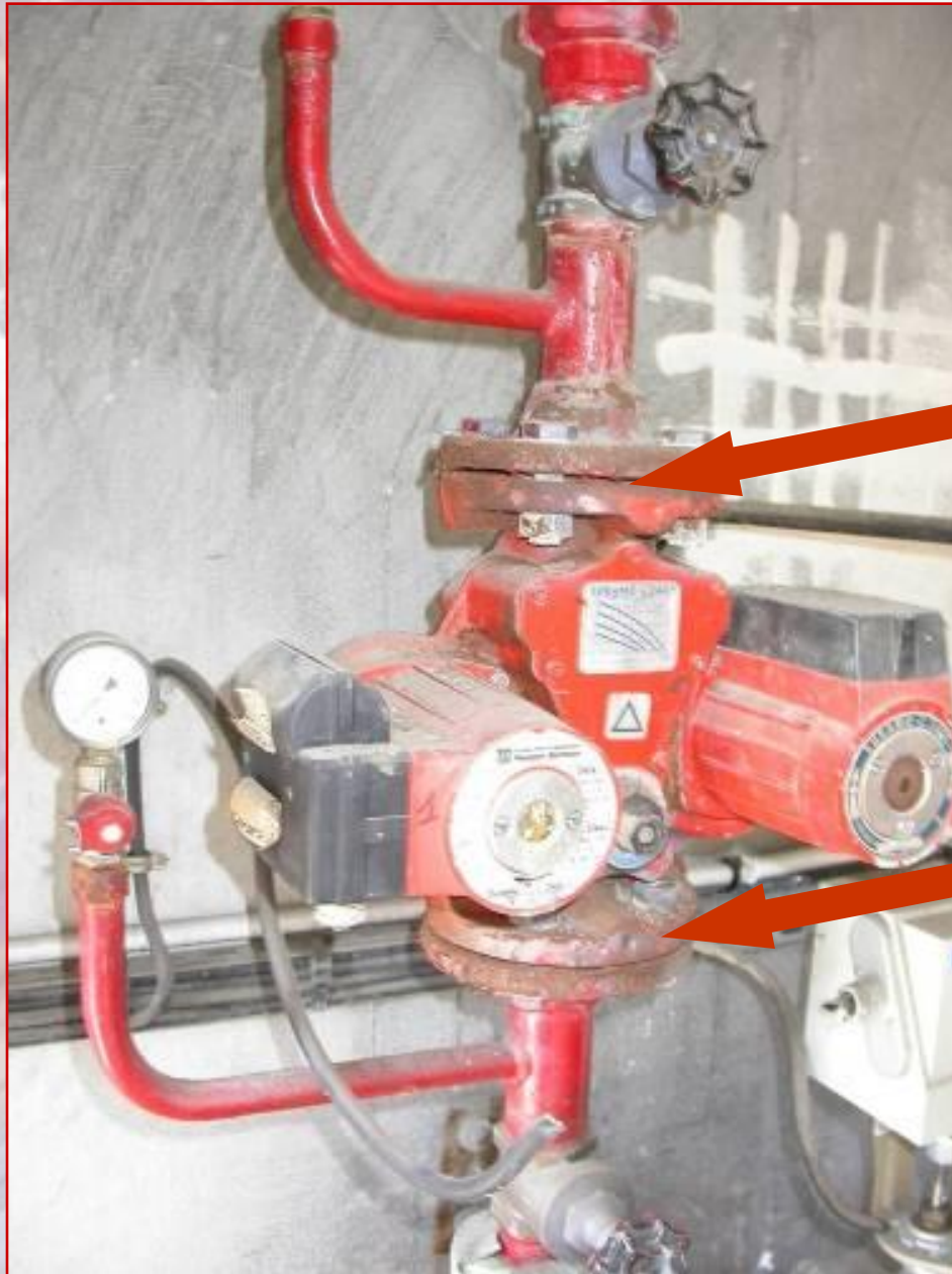
Jointes amiantés entre brides
