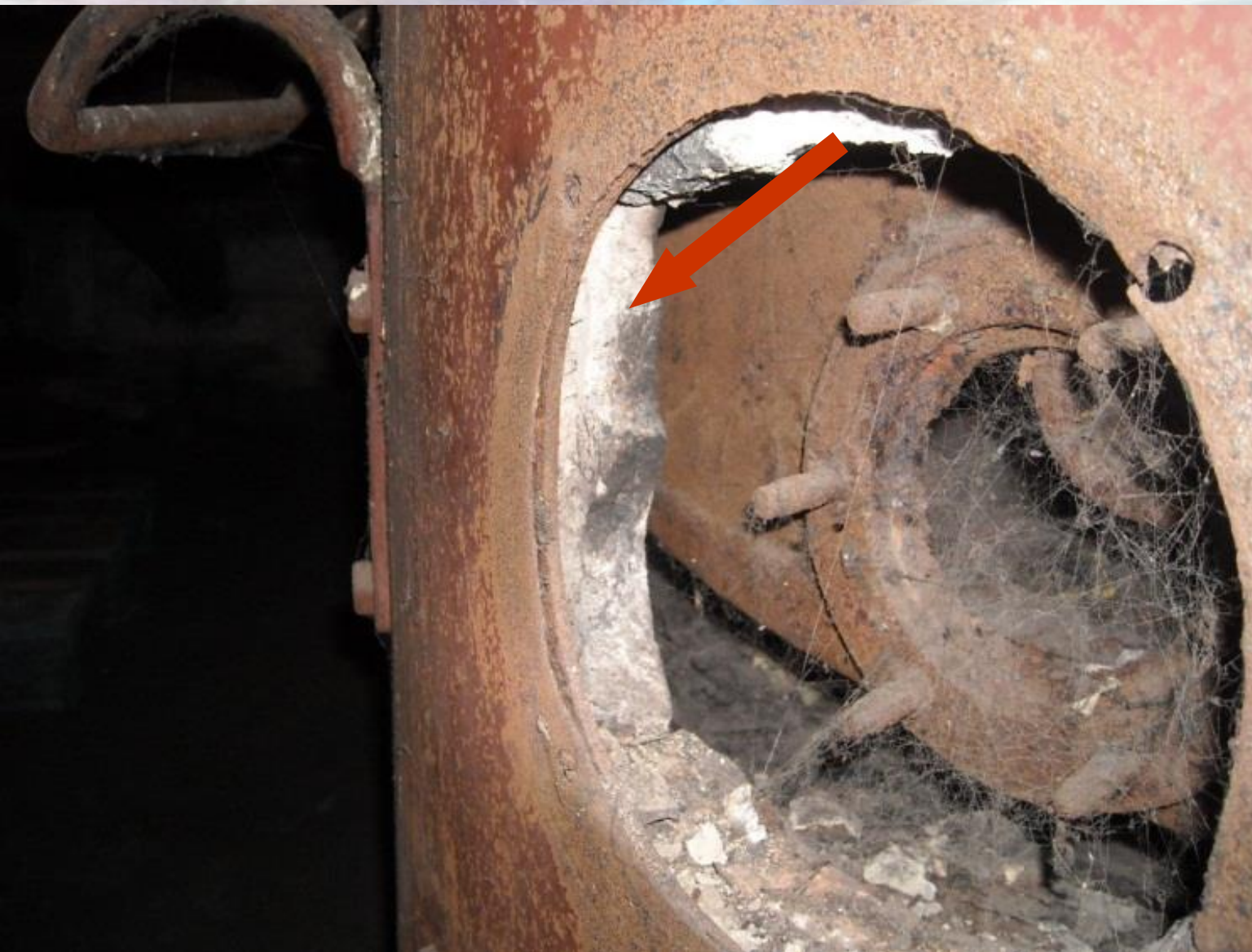
Briques amiantées dans chaudière
