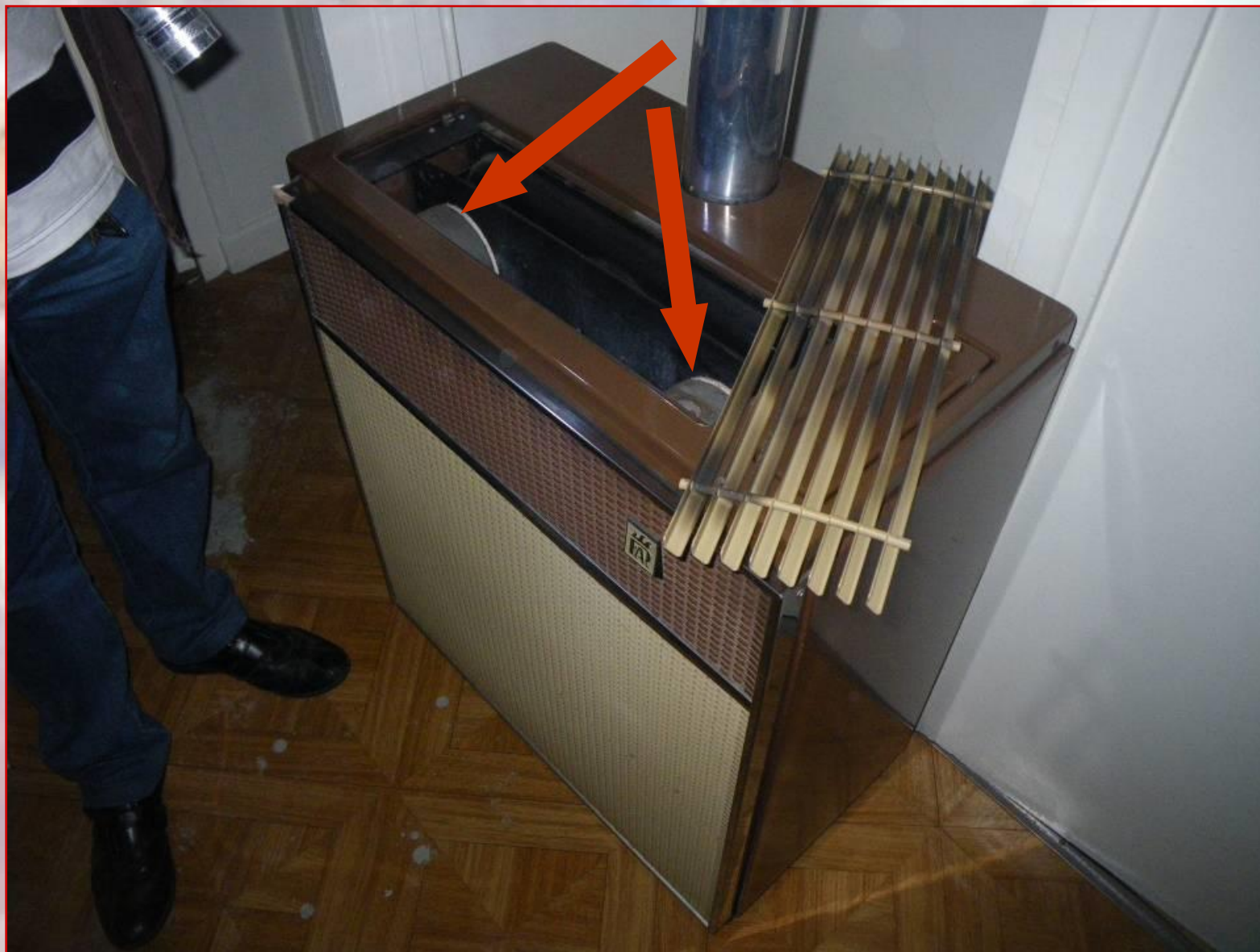
Joints amiantés sur chaudière à gaz
