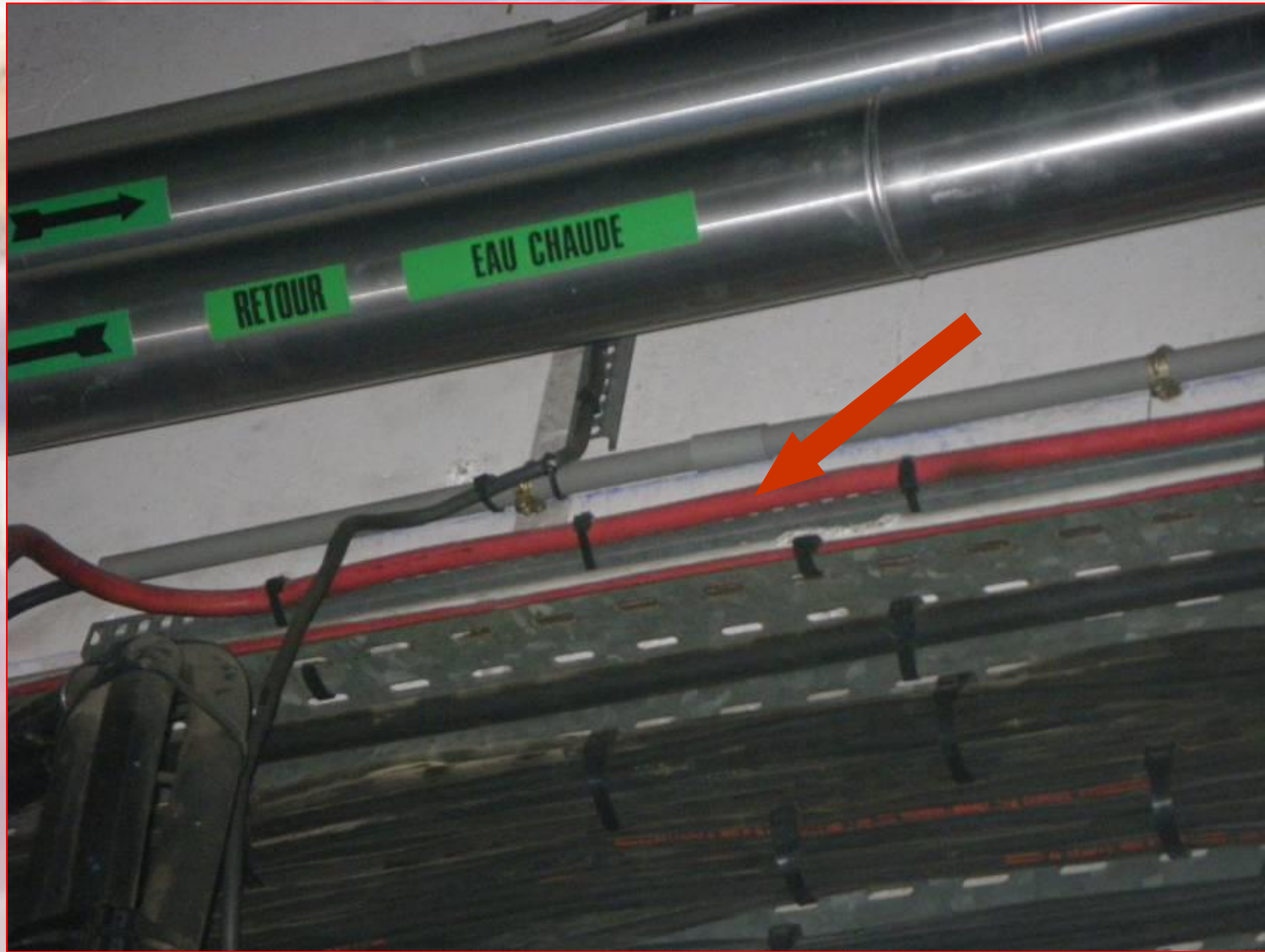
Câble (orange) contenant une gaine en amiante
