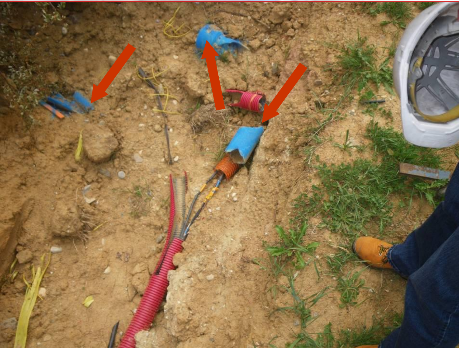
Tuyau fibro amiante
