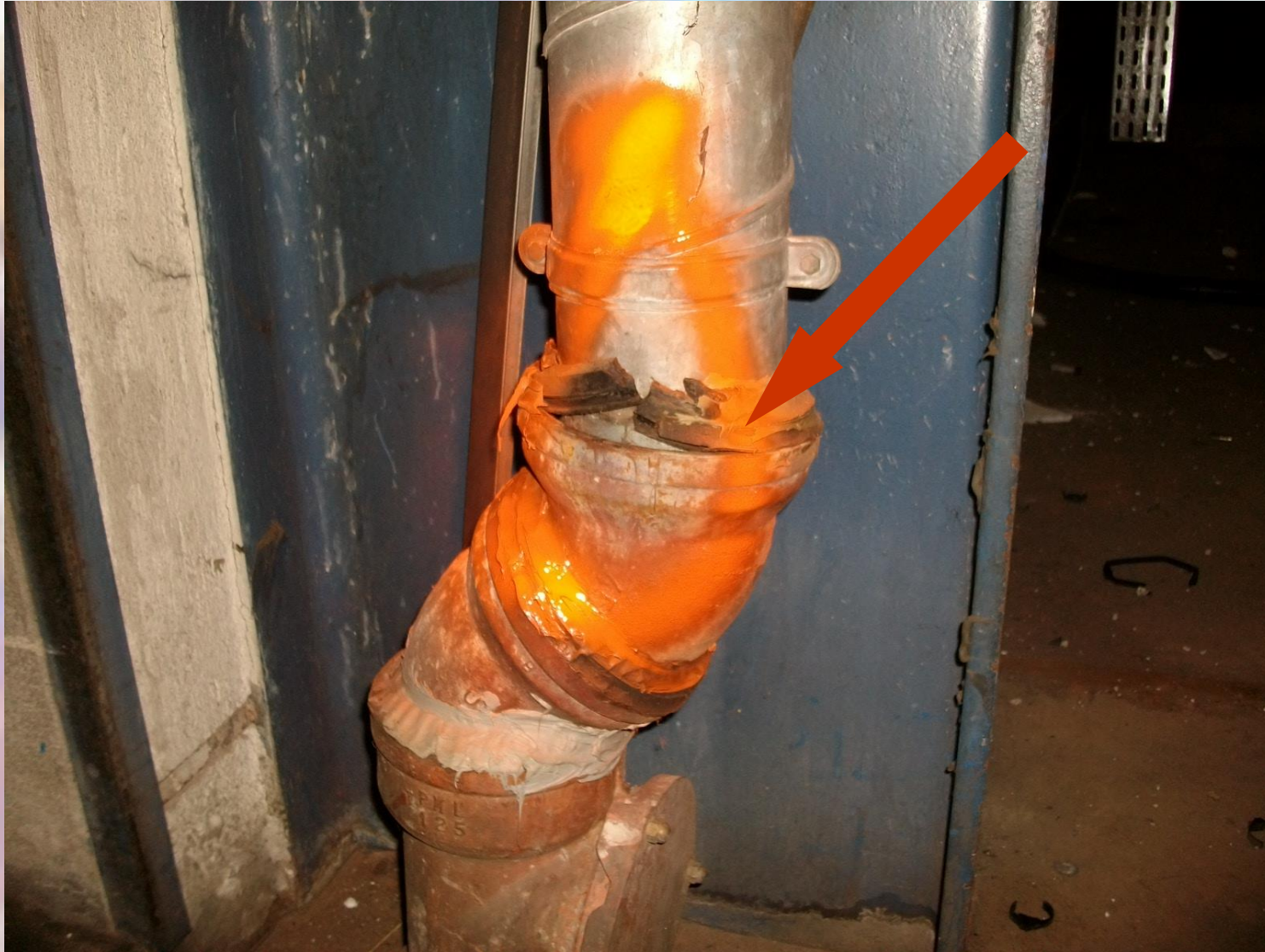
Joint caoutchouc amianté sur tuyauterie fonte
