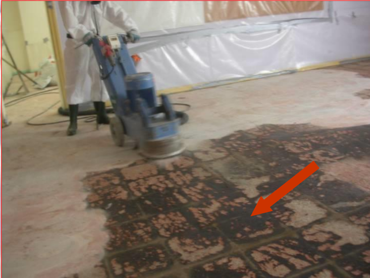
Colle bitumineuse amiantée
