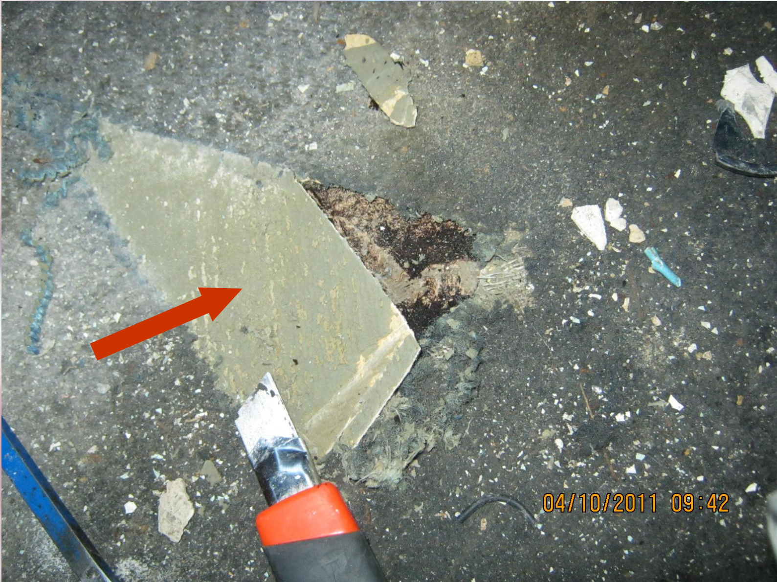
Moquette avec sous couche amiantée
