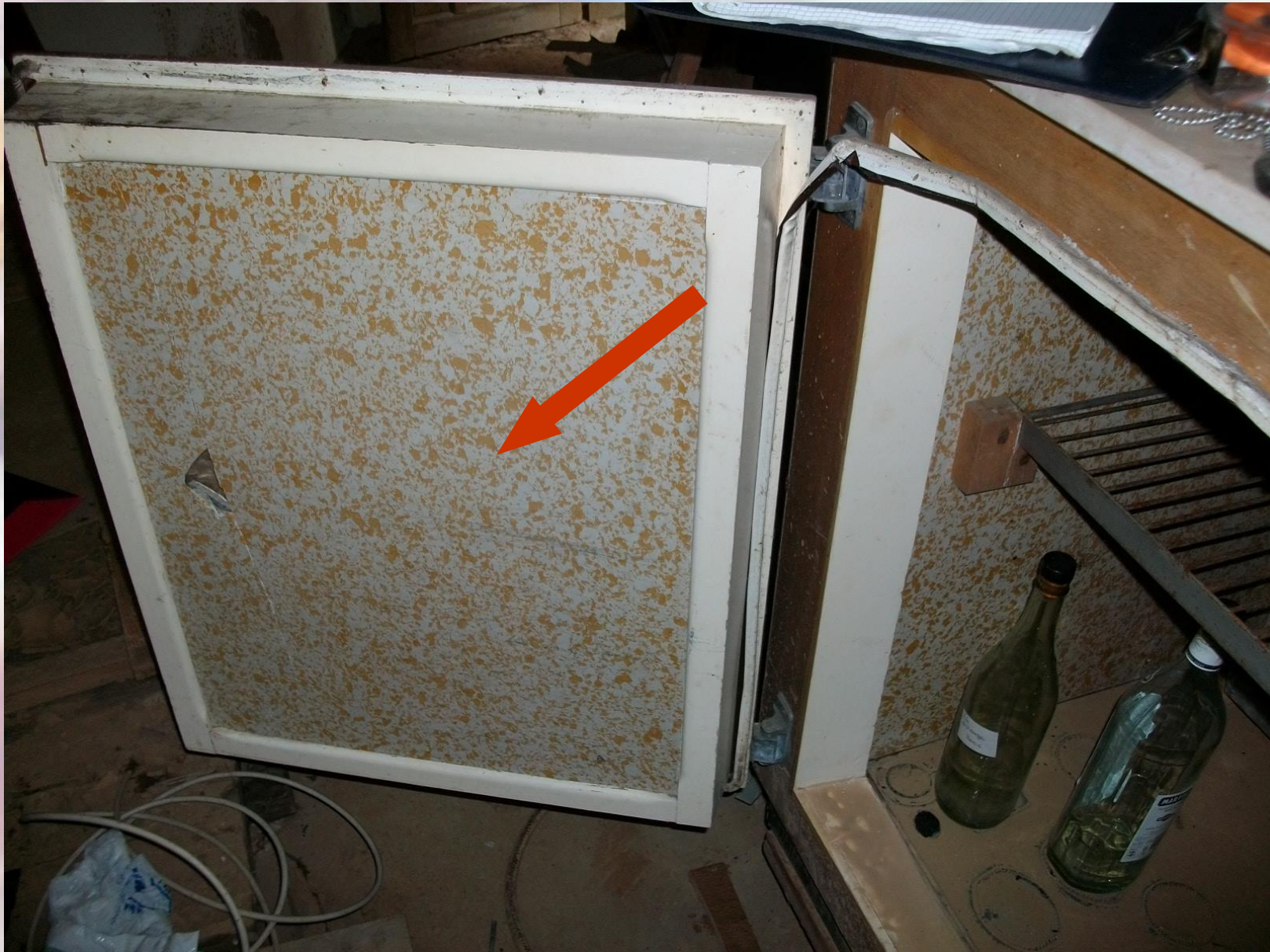
Plaque isolante amiantée dans armoire frigorifique
