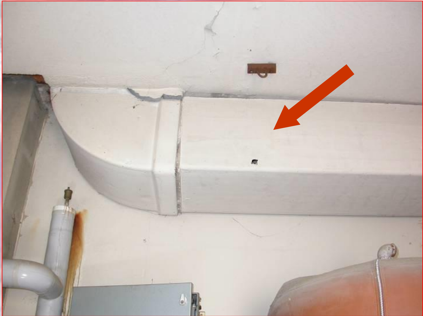
Conduit d'aération en fibrociment
