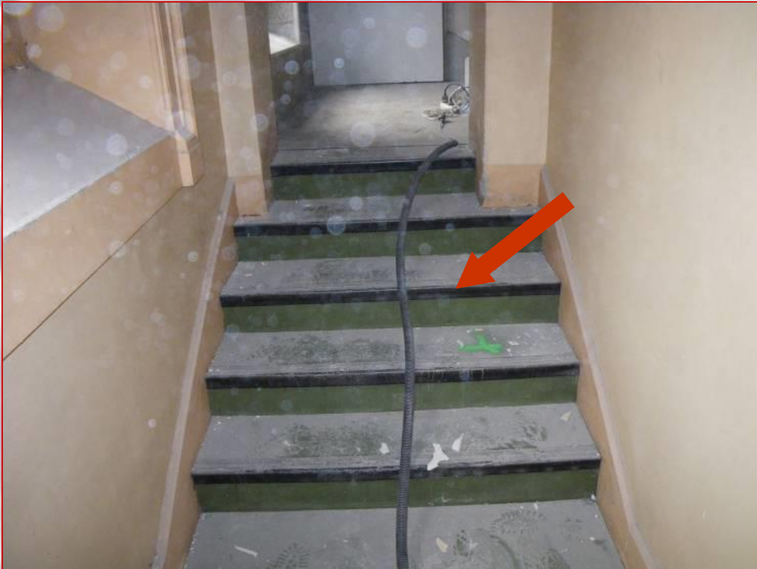
Escalier avec nez de marche amiantés
