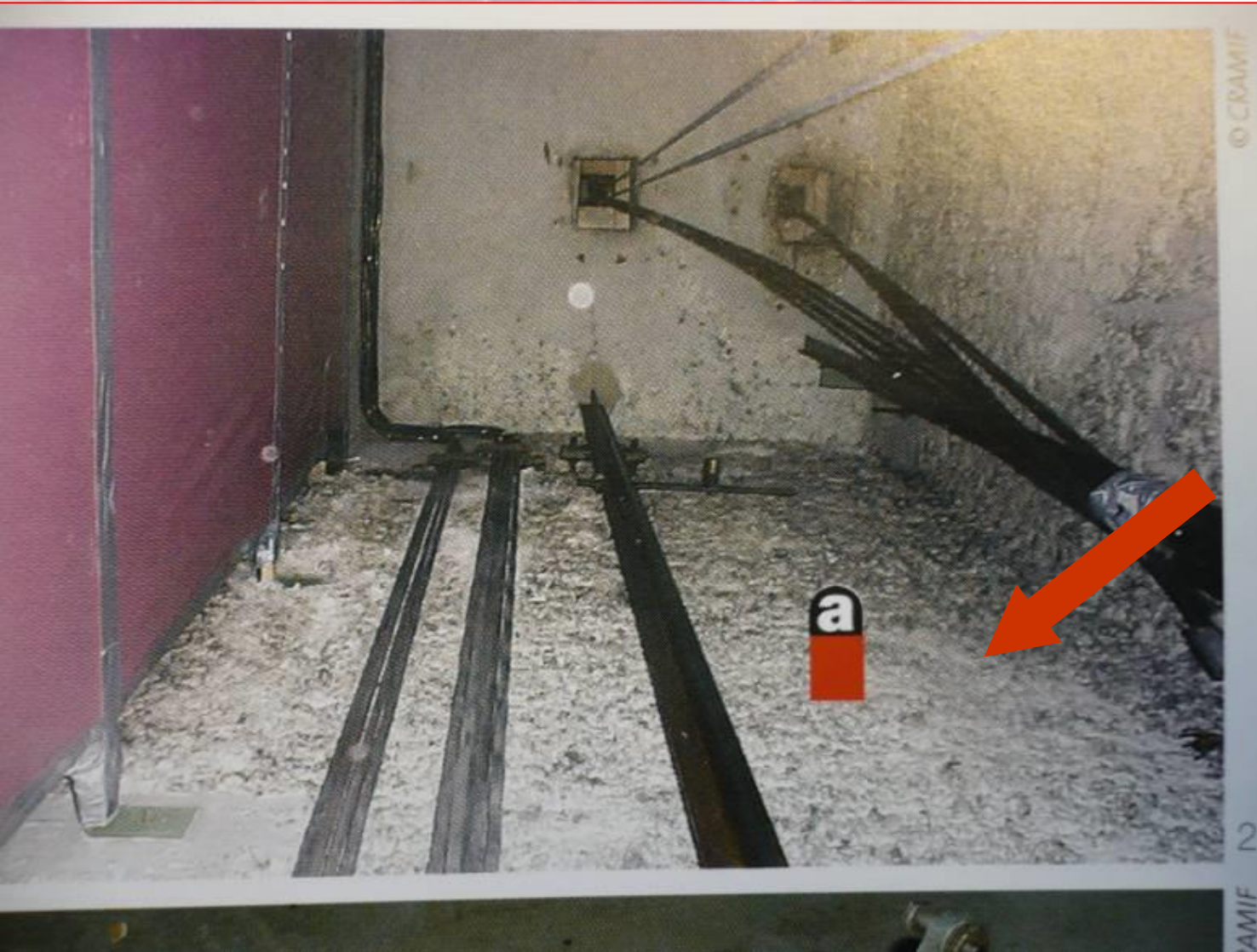
Flocage amiante (trémie d'ascenseur)
